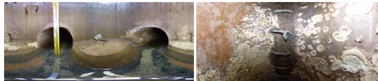
マンホール内部の点検事例、マンホールの全周について腐食、ズレ、クラックの状況を把握できます
